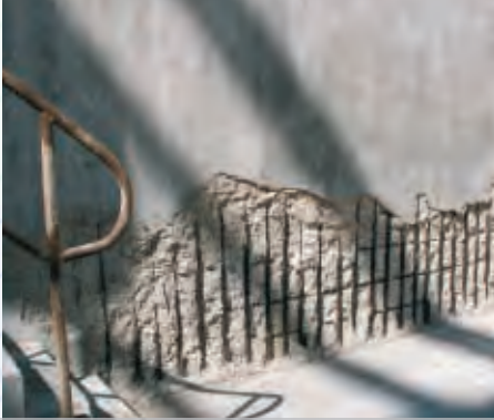
Abb. 5: Betonkorrosion durch Phosphorsäure in einer Auffangtasse
