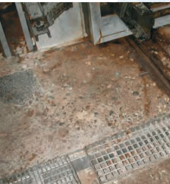
Abb. 3: Betonkorrosion in einem Chemiebetrieb
