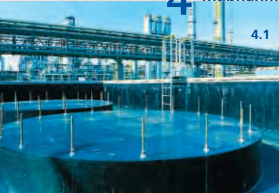
Abb. 13: Mechanisch verankerte Kunststoffauskleidung in einer Auffangtasse
