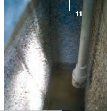
Abb. 7: Betonkorrosion durch saure Abwässer in einer Sammelgrube
