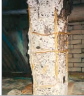
Abb. 6: Betonkorrosion durch Salzsäure unter einem Heizbehälter
