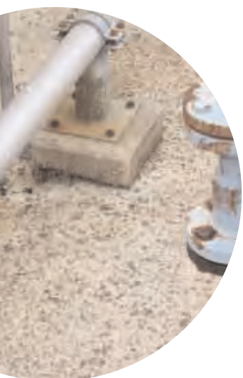
Abb. 4: Betonkorrosion durch Salpetersäure in einer Auffangtasse
